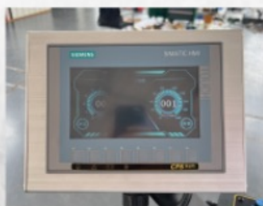
西门子PLC系统 精准操控 稳定可靠
